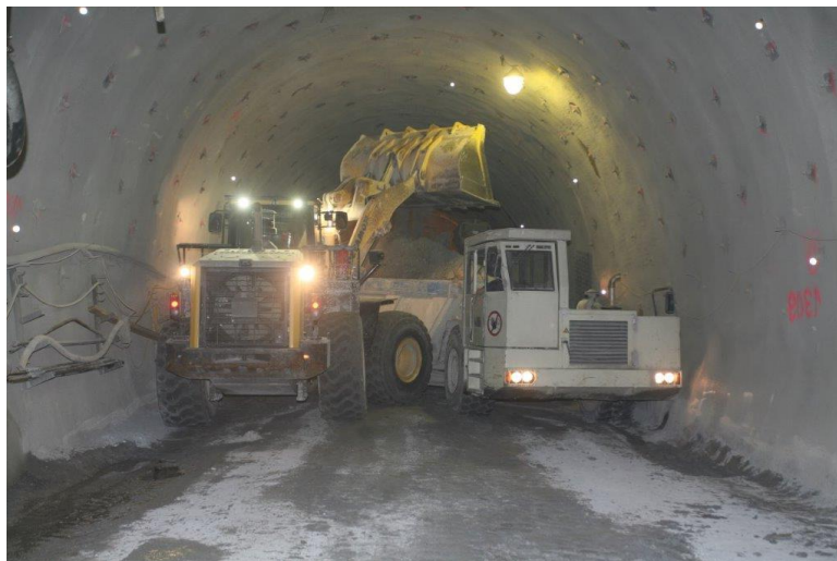
Die Regeneration der im Tunnelbau vorgeschriebenen Dieselpartikelfilter verläuft problemlos. Im Bild einer der vier Komatsu Radlader WA 470, die an der Ortsbrust das Material verladen. Ob Beladung der Transportfahrzeuge an der Ortsbrust oder Beschickung des Brechers: die Komatsu Radlader bewähren sich im Tunnel Gloggnitz auch unter engen Verhältnissen.
