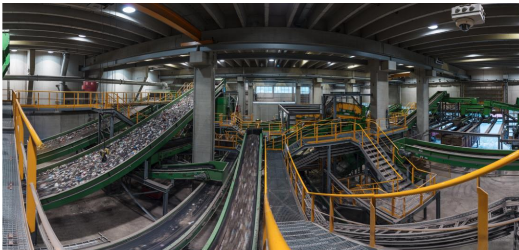
Blick in die mechanische Abfallsortieranlage, die als gekapseltes System über eine mehrstufige Abluftreinigung mit Biofilter verfügt und zu den modernsten Anlagen Österreichs zählt.
