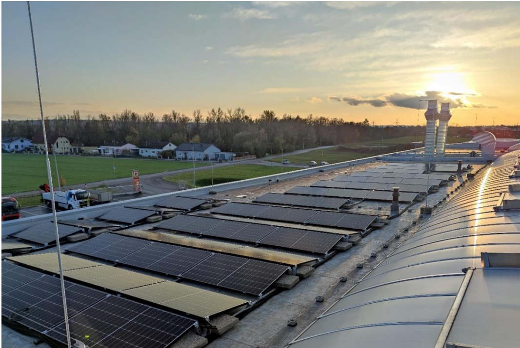
PV-Anlage am Dach der Firma Kuhn am Standort Traun (OÖ) ©PVplus GmbH
