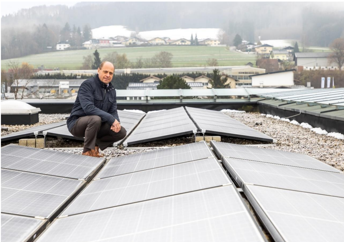
Mag. Gerhard Ortner (Leiter Controlling) bei der PV-Anlage auf dem Dach des Headquartiers in Eugendorf.
