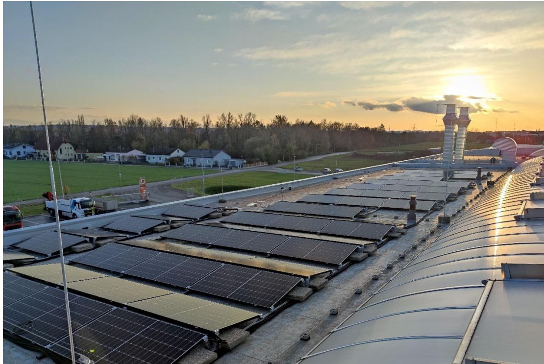
Photovoltaik-Anlage am Dach der Firma KUHN am Standort Traun (OÖ).
